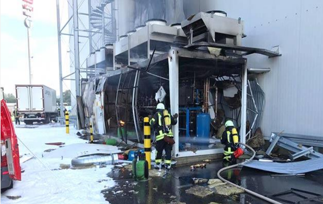
Pakastevaraston propaanikylmäkoneiston konehuoneessa tapahtui huoltotyövirheen vuoksi räjähdys Saksassa 2017
