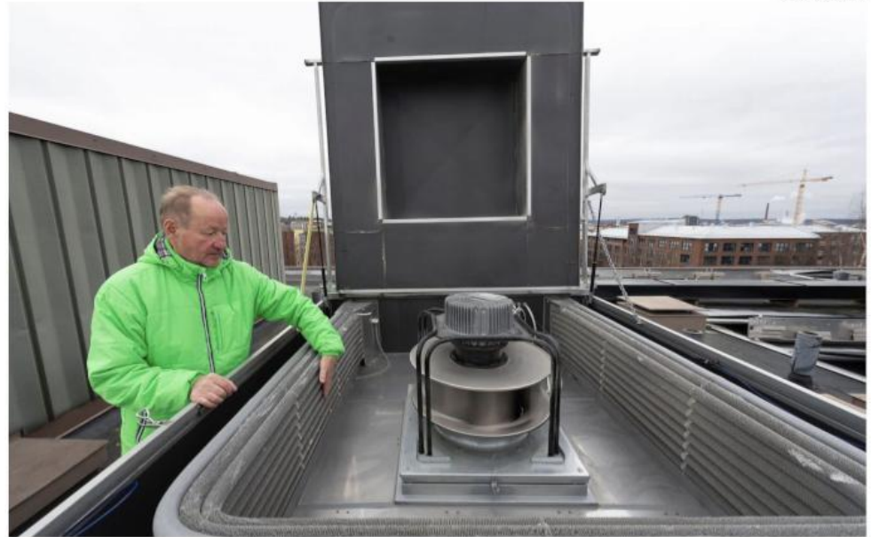
Taloyhtiön katolla ilmanvaihdon lämmöntalteenottoa esittelee yhtiön hallituksen puheenjohtaja Pertti Vesterinen. Energiategokkuuskorjaukset ovat pudottaneet yhtiön hiilijalanjälkeä 94 prosenttia.
